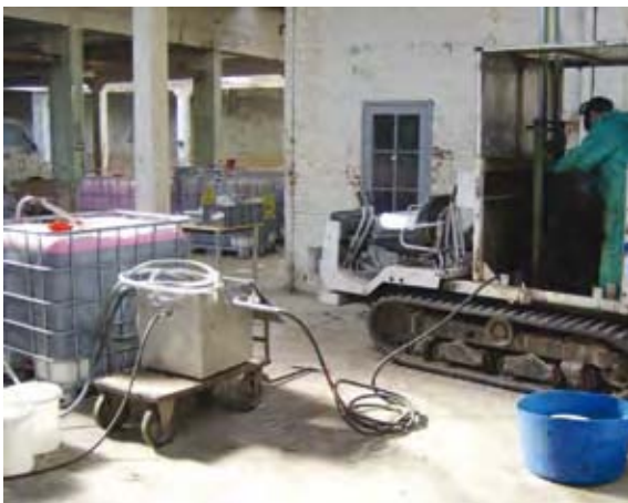
NaMnO 2 injection equipment
